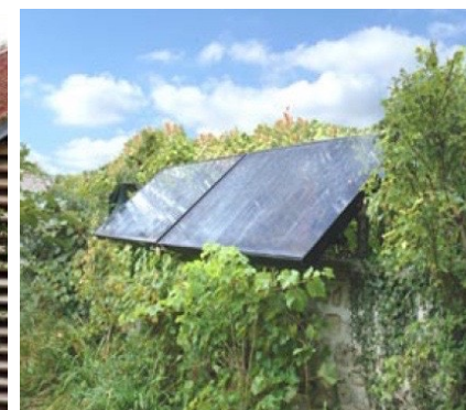
Capteurs isolés de la construction et posés au sol, ou adossés à un mur.
