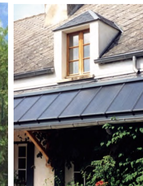
Les capteurs s'intègrent dans les protections solaires
